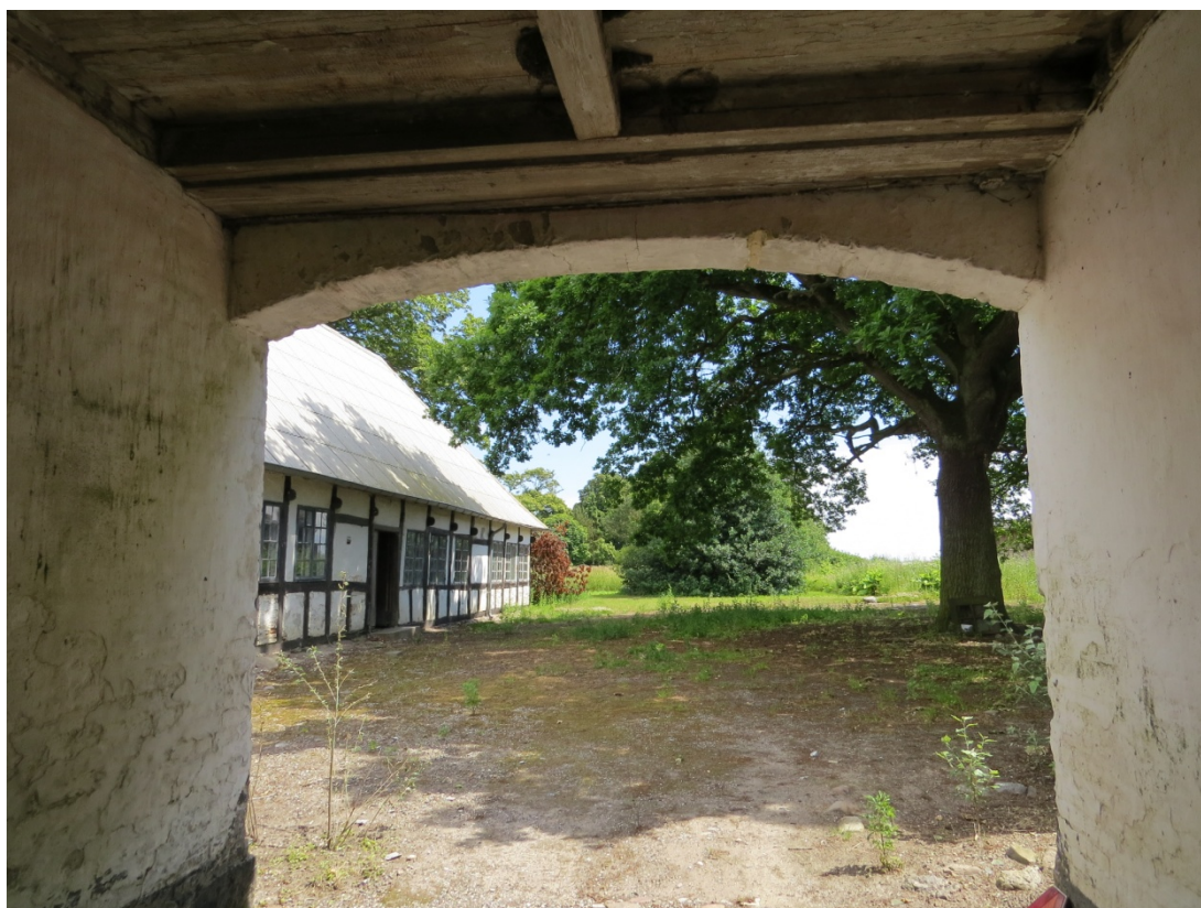
Kig ind på gårdspladsen i 2015. Gården er ubeboet og ved at forfalde
