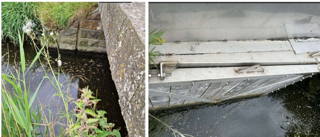
Figur 3.9 Pumpekanalens udløb i Guldborgsund med højvandslukke. Foto NIRAS juli 2024.
