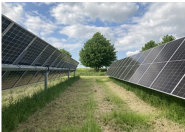
Eksempel på opstilling med tracker paneler
