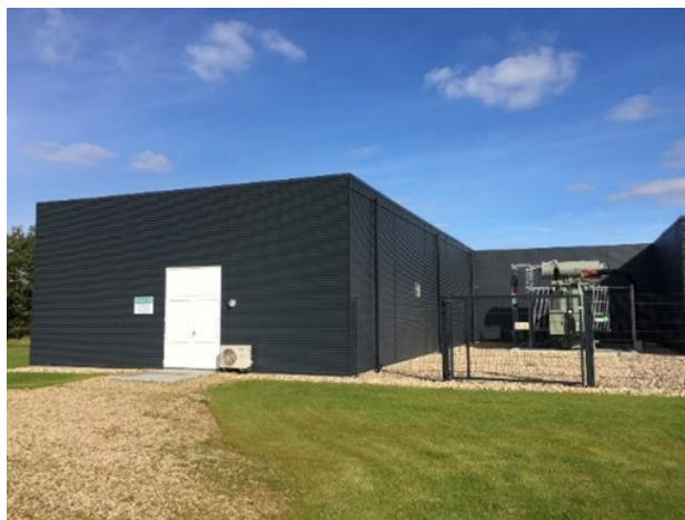
Eksempel på transformerstation
