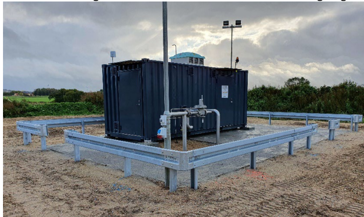
Figur 9 - Foto som viser eksempel på en BMR-station
