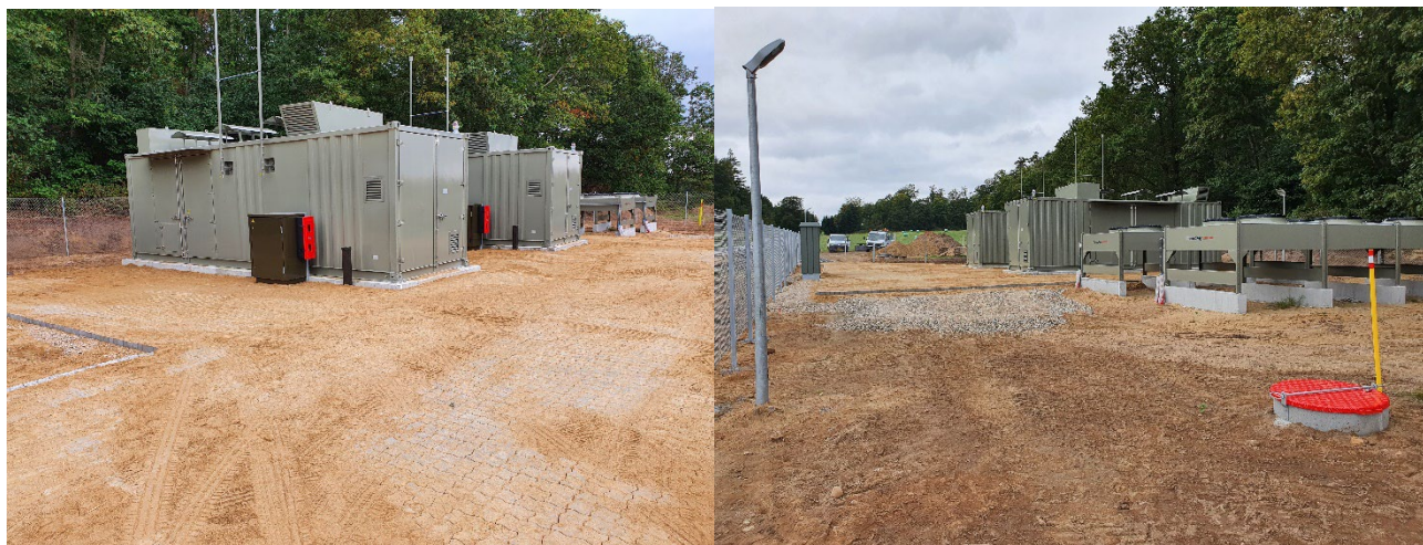
Figur 11 - foto til venstre viser 2 kompressor-containere med tilhørende el-skab (foran) og kølere (bagerst).
