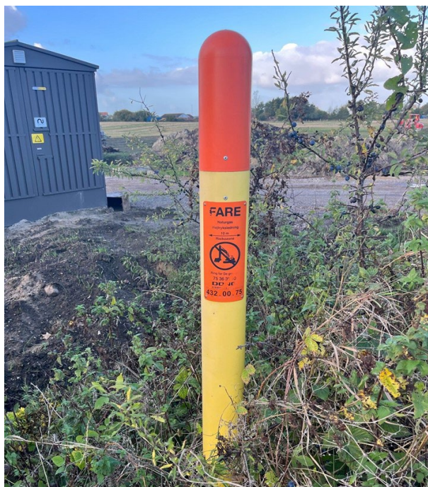
Figur 15: eksempel på mærkestander, der markerer gasrørledningens tilstedeværelse under jordoverfladen.
